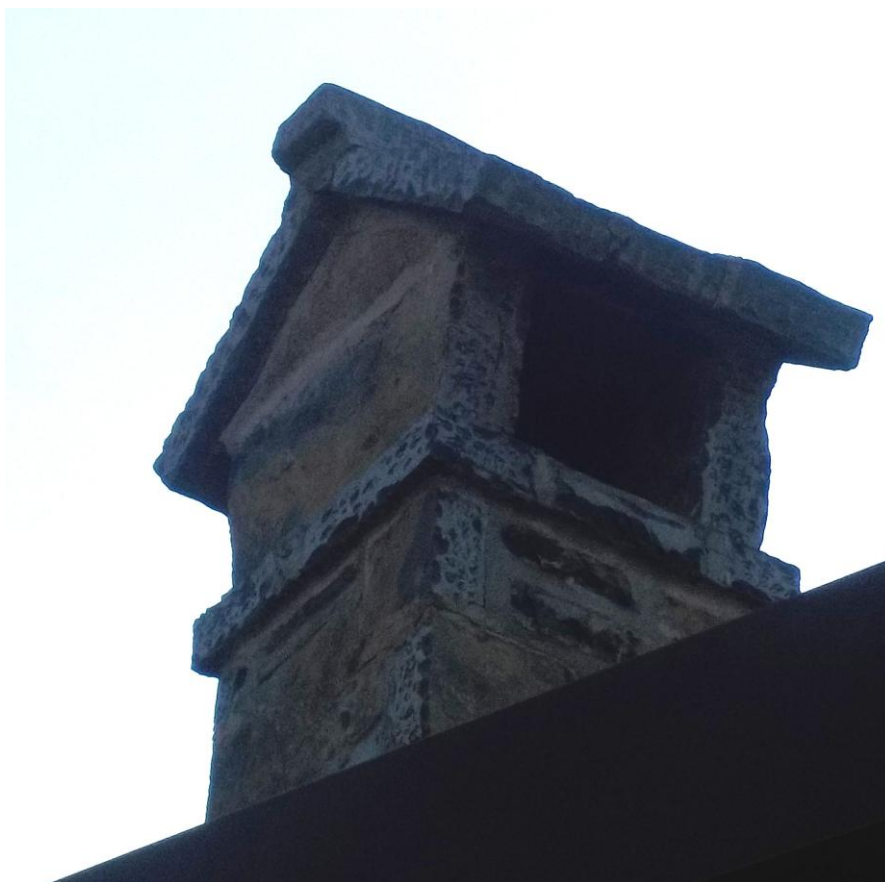
Cheminée un peu plus sophistiquée, toute en pierres cimentées. Maison Locatelli.
