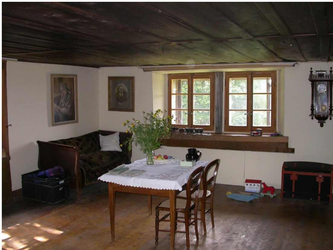
L'une des rares pièces de la maison encore en un état convenable. Néanmoins le plafond, sombre et bas, mange une partie de la belle lumière provenant côté Vallée.
